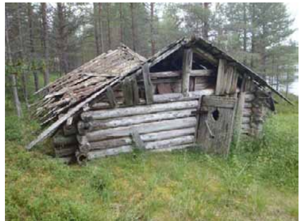
Rakennus 5 on yhä pystyssä, mutta katto on jo todella huonossa kunnossa. Kuva otettu etelään.
