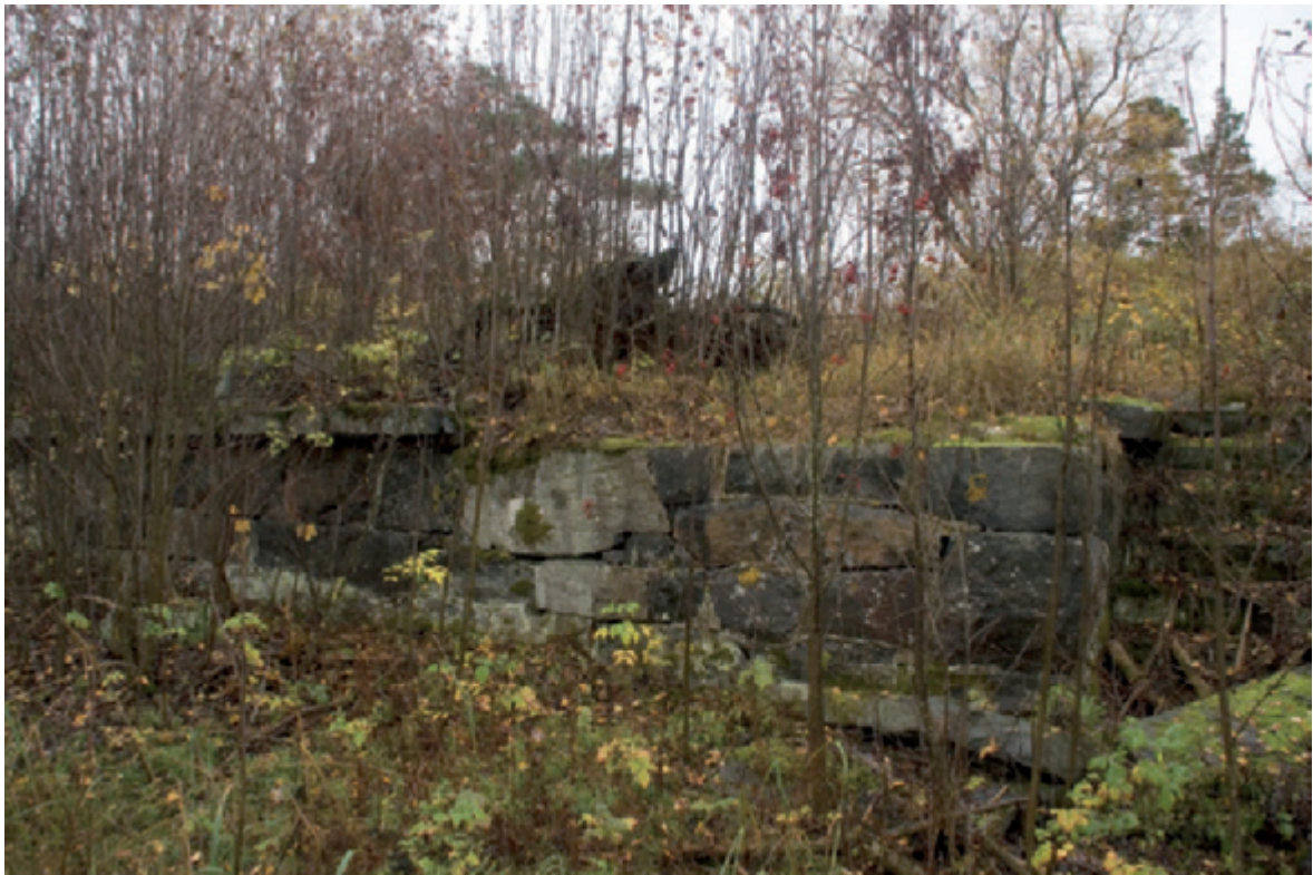
Kuva 19. Kuninkaansaaren patteri I. Rappusten vasemmalla puolella oleva räystäskiveys on osittain hajonnut. Kuva: Henrik Jansson.
