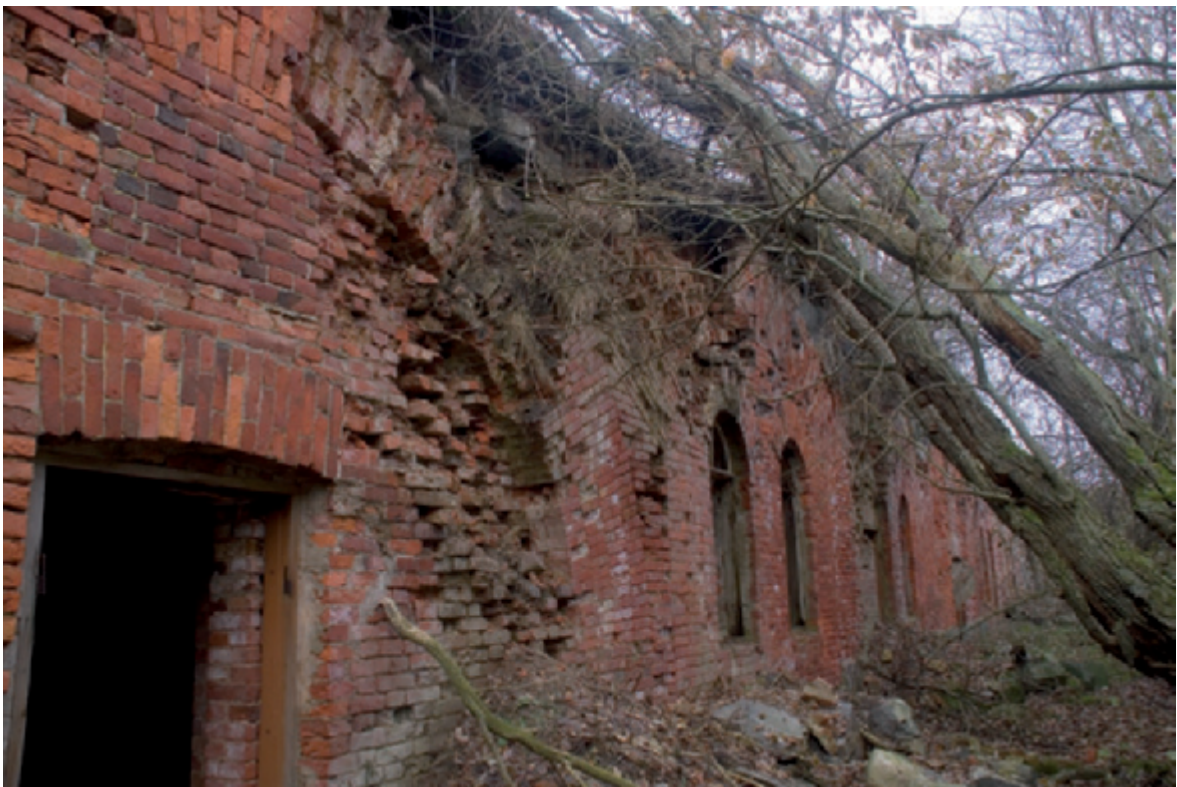
Kuva 22. Vallisaari patteri VII. Kyseinen miehistönsuojaksi muutettu patteri on erittäin huonosti säilynyt ja suuria osia sen fasaadista ja sisätilojen holvauksista on romahtanut. Kuva: Henrik Jansson.
