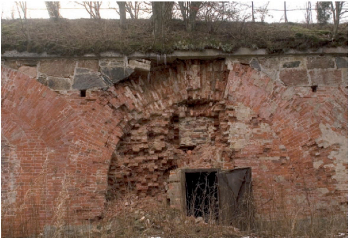
Kuva 21. Vallisaari patteri VIII. Puun juurien aiheuttama siirtyminen on romahduttanut osan fasaadia. Kuva: Henrik Jansson.
