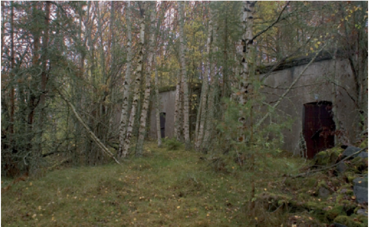
Kuva 36. Kuninkaansaaren umpeenkasvanut patteri V. Patterissa on monin paikoin paikallisia vaurioita. Kuva: Henrik Jansson.
