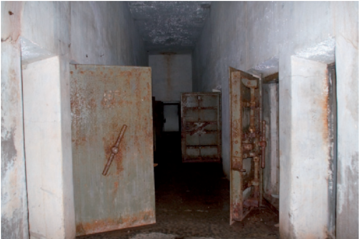
Kuva 25. Kuva suojautilasta, jossa on pieniä kosteusvaurioita. Kuvassa näkyvät myös massiiviset rautaovet. Kuva: Henrik Jansson.
