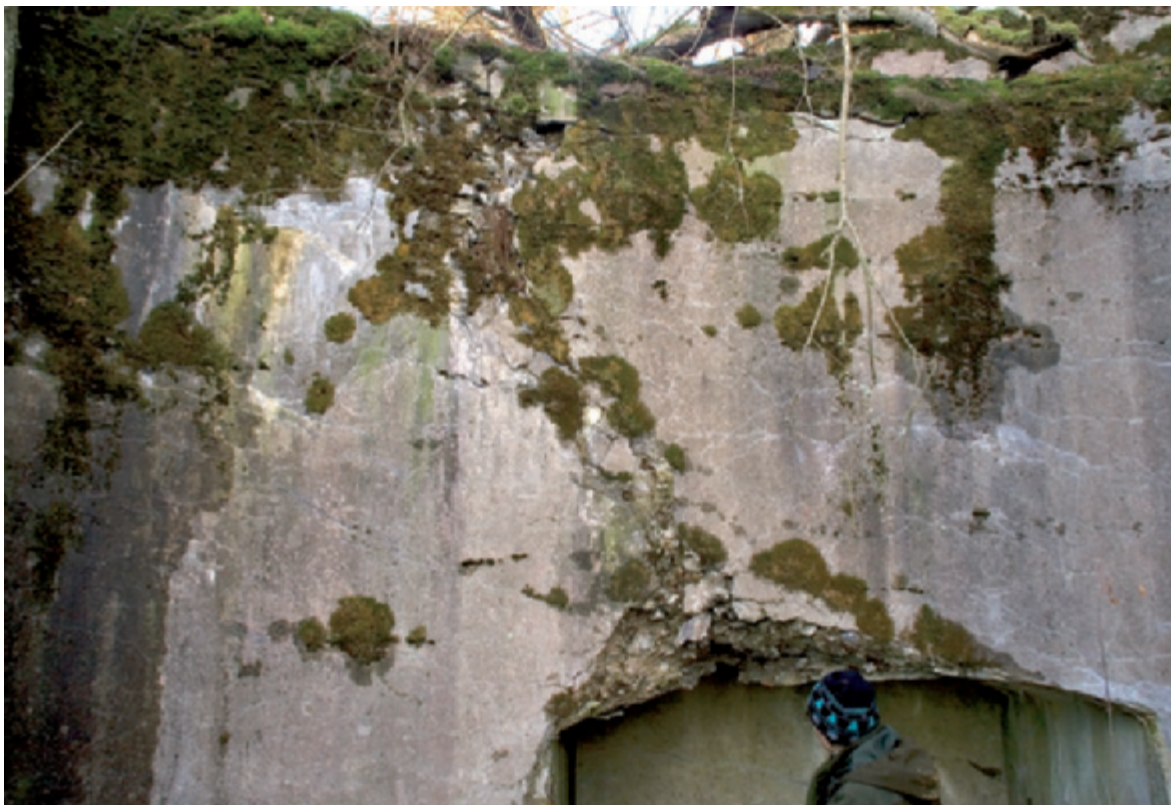
Kuva 23. Tyypillisiä halkeamia betonipinnassa, jotka alkavat katto-osasta ja leviävät alaspäin. Vaakapintojen päällä vaurio leviää usein leveäksi pintavaurioksi, koska siinä kohdin vesi jää seisomaan rakenteen sisälle. Kuvan alaosassa Museoviraston tutkija Päivi Maaranen. Kuva: Henrik Jansson.
