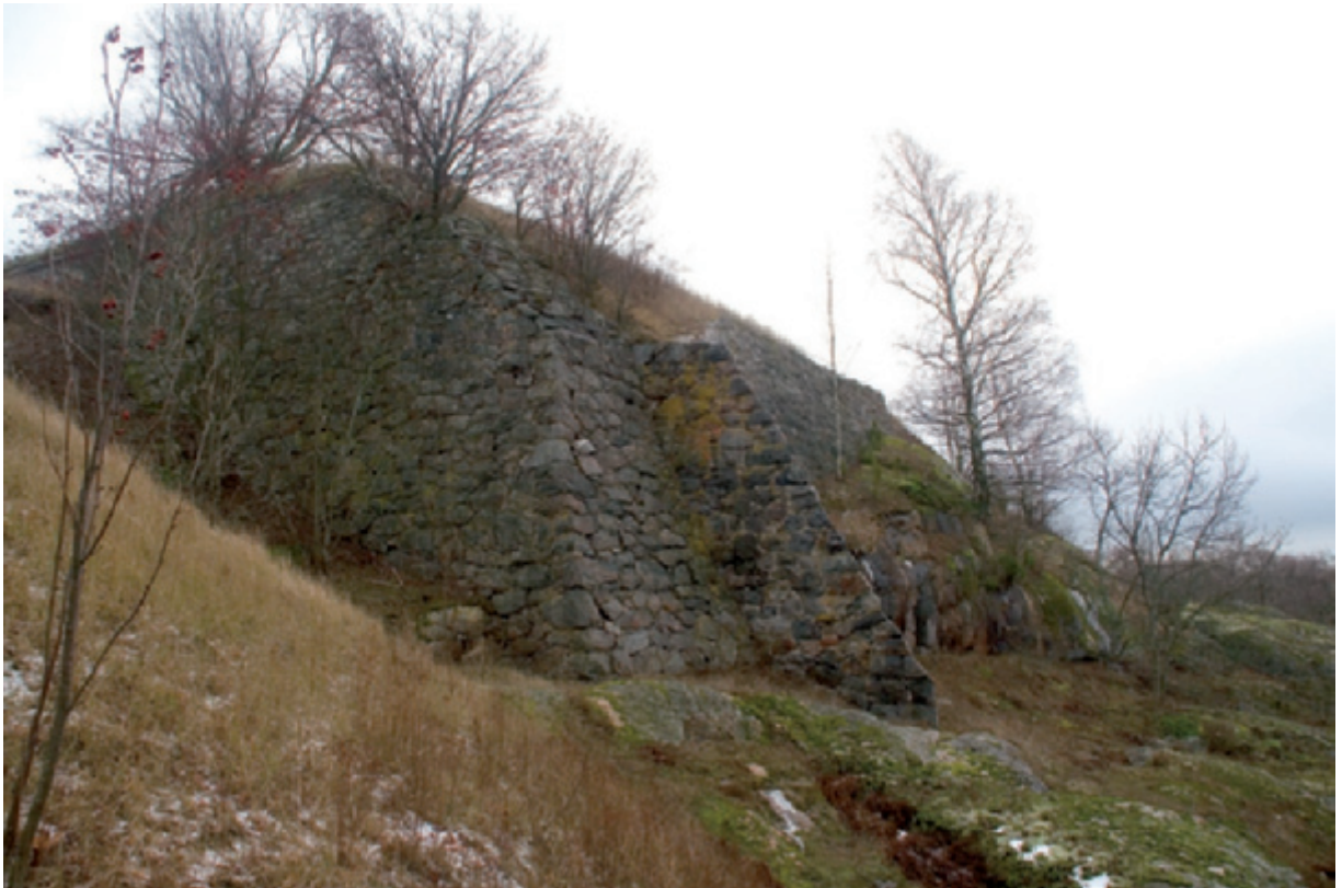
Kuva 18. Vallisaaren patteri VI, massiivinen rintavarustuksen tukimuuri, joka on haljennut monesta kohtaa kasvillisuuden aiheuttamien liikkeiden vuoksi. Kuva: Henrik Jansson.
