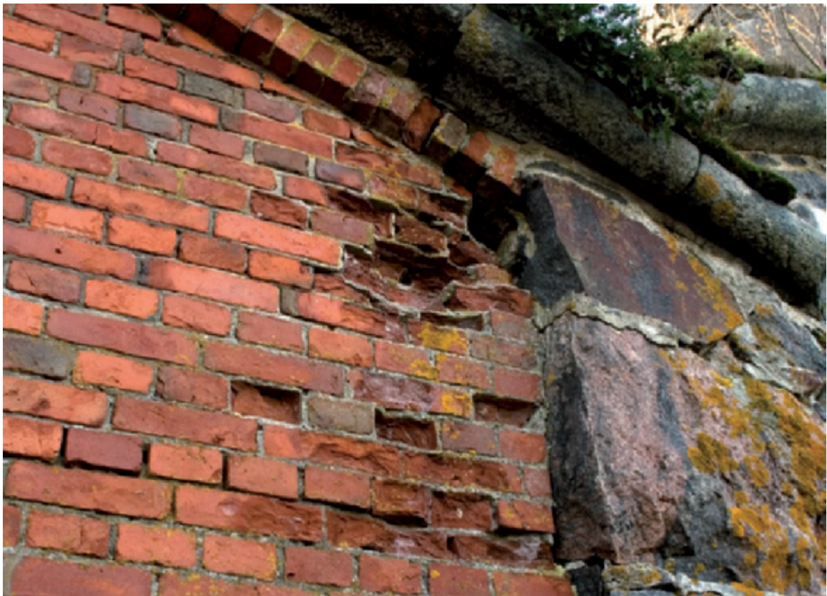
Kuva 20. Kuninkaansaari patteri II. Lievä ja paikallinen vaurio tiilimuurauksessa. Kuva: Henrik Jansson.
