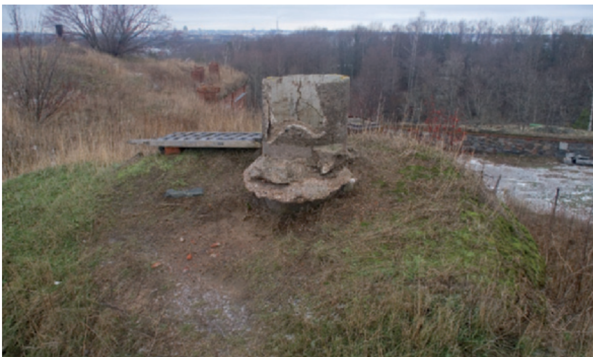
Kuva 29. Vallisaaren patteri VI. Etualalla hajonnut tuuletuskuilu ja eroosioaurio. Kuilun takana ristikko-ovi, joita lojuu eri puolilla aluetta. Kuva: Henrik Jansson.
