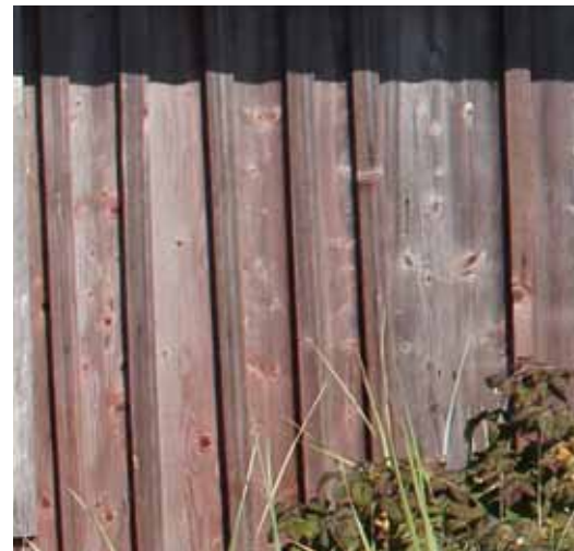
Åldrande fasad behandlad med rödmylla Vanheneva punamullattu julkisivu
