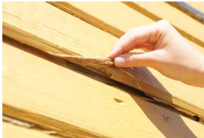
Akrylatfärg - rötskador Akrylaattimaali - lahovaurioita
