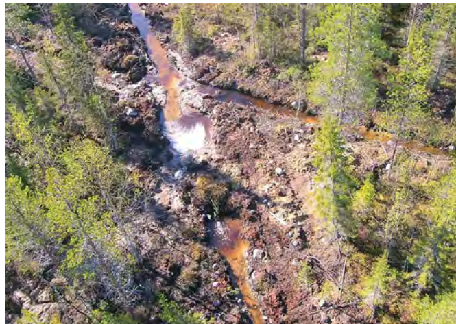
Kuva 80. Virtaamaa säätelevä putkipato ojituskohteella. JURI LAURILA.
