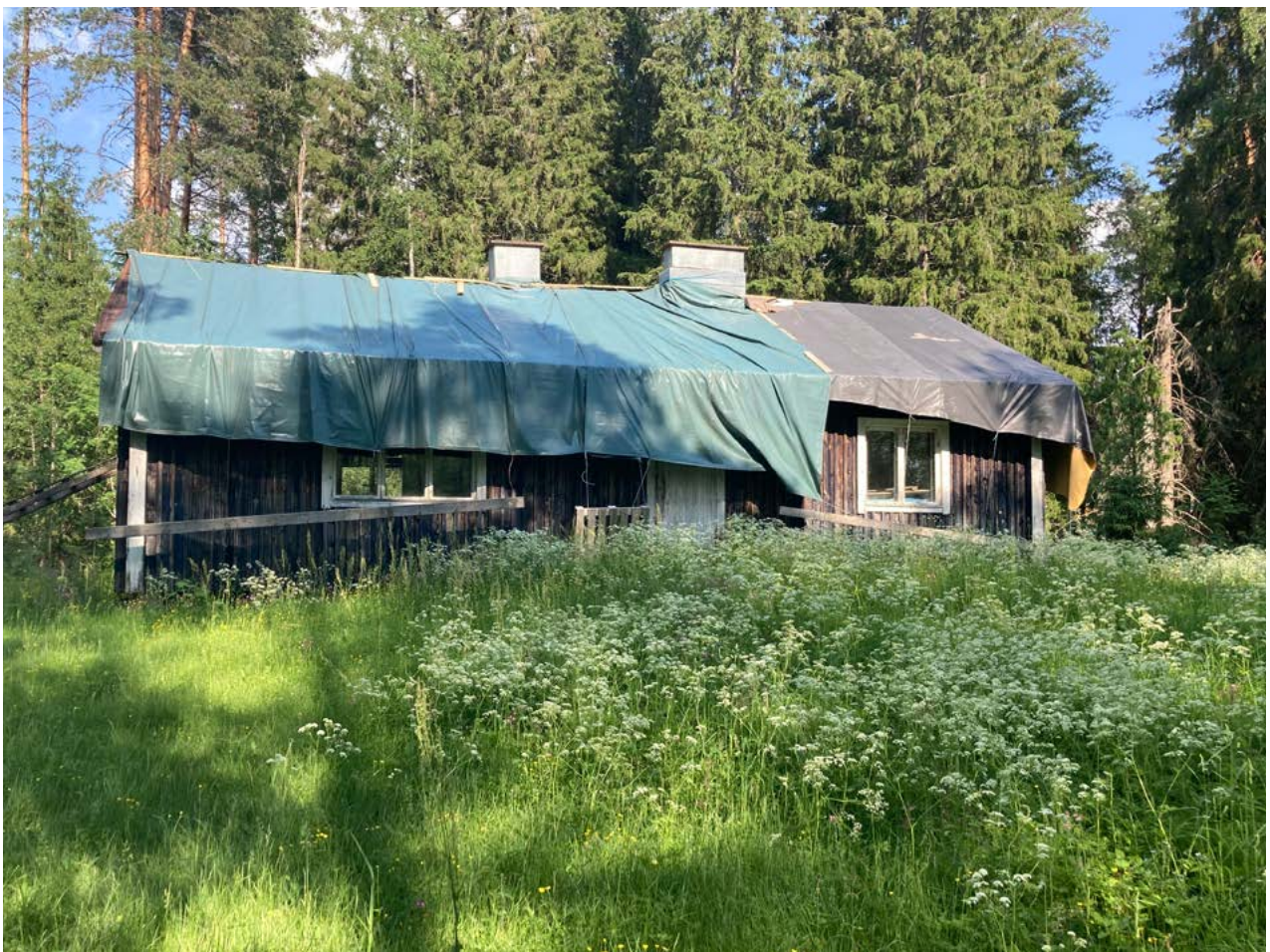
Rakennus kuvattuna idän suunnasta. Kattoa on pyritty suojaamaan pressuin. Kuva: Saatsi Arkkitehdit.
