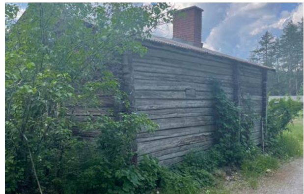
Useimmissa rakennuksissa matala kivijalka ja korkea kasvillisuus pidättävät kosteutta runkorakenteessa. Mustasaaren pientalo. Kuva: Saatsi Arkkitehdit.
