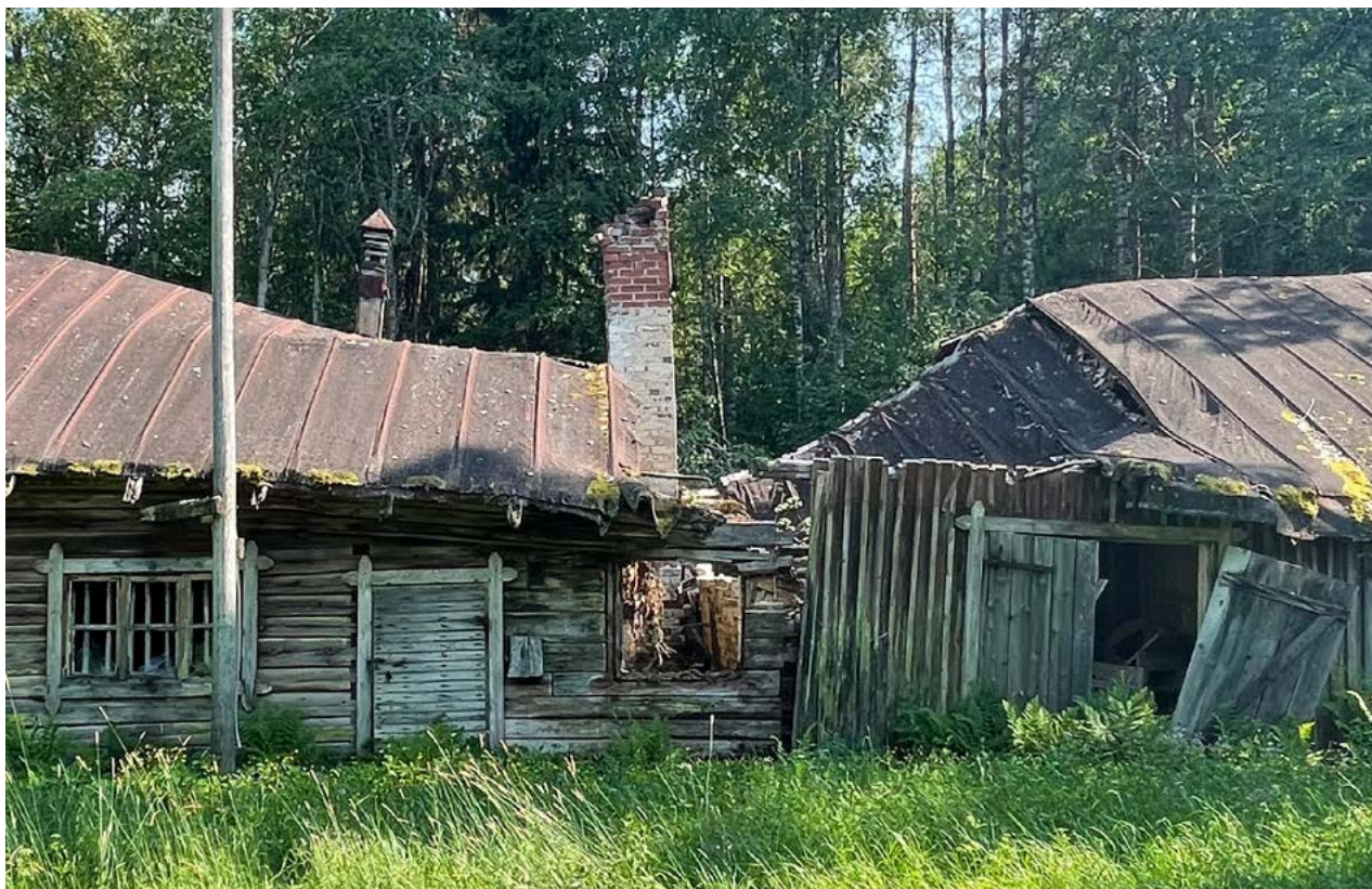
Vaurioitunut kate johtaa nopeasti muunkin rakennuksen vaurioitumiseen. Niinimäen navetta. Kuva: Saatsi Arkkitehdit.
