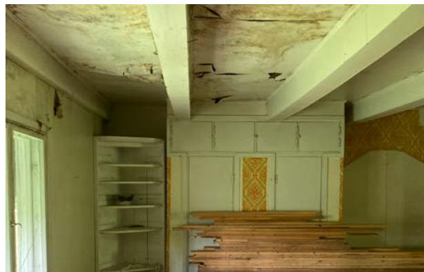
Sisäkatto on paikoin erittäin huonossa kunnossa. Kuva: Saatsi Arkkitehdit.
