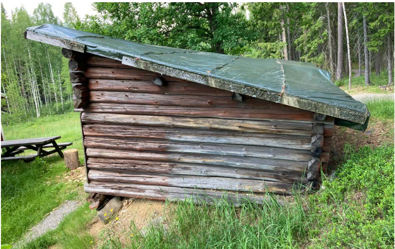
Rakennus etelän suunnasta. Kuvassa oikeassa reunassa sijaitseva nurkka on luhistunut. Kuva: Saatsi Arkkitehdit.
