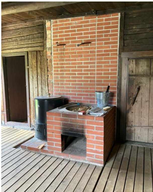
Pesutuvan muurattu tulisija ja muuripata. Oikealta käynti saunaan. Kuva: Saatsi Arkkitehdit.
