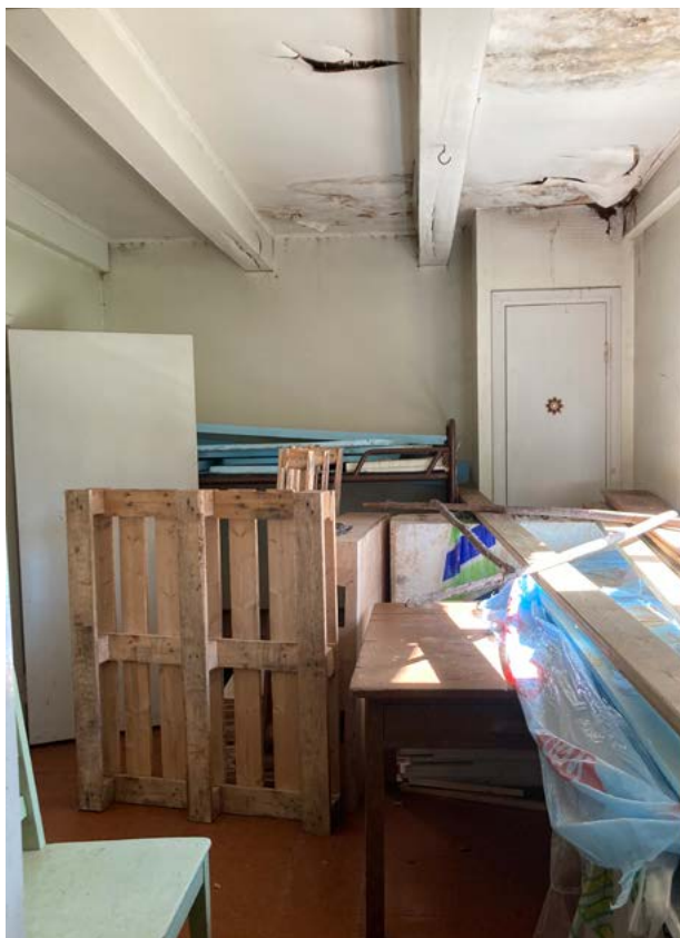
Pohjoispäädyn ensimmäinen huone. Sisäkatto-pinta on pinkopahvitettu. Pinta on huonossa kunnossa. Kuva: Saatsi Arkkitehdit.
