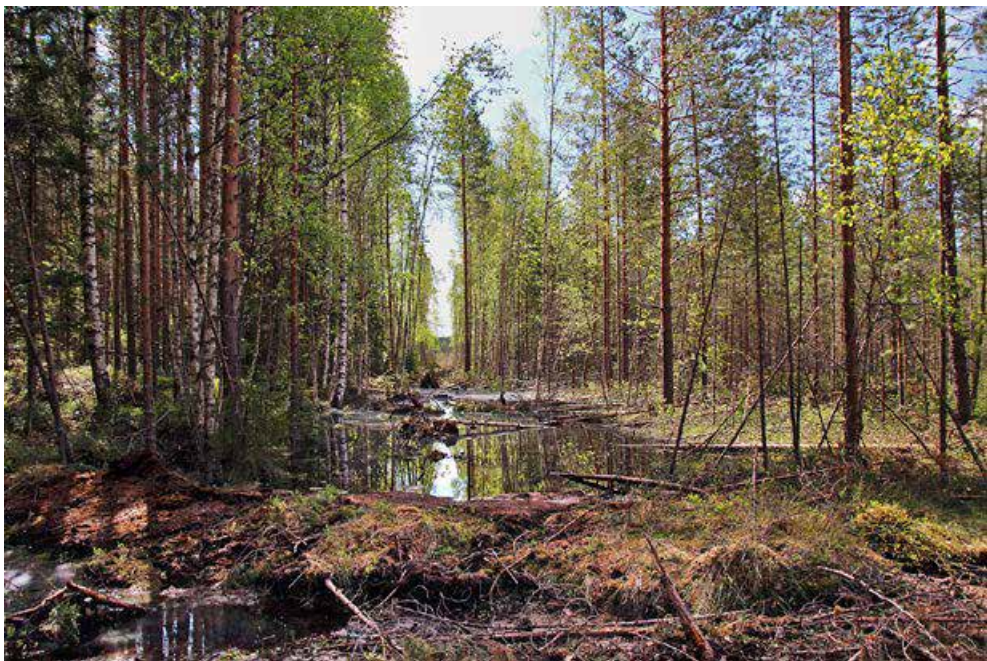
Kuva 29. Petäjäveden Teerijärvensuota ennallistettaessa ojalinjoilta ei raivattu puustoa. Kuvissa näkyy täytettynä keidassuon ja kivennäismaan välinen reuna-oja, jossa virtasi runsaasti vettä. Ojamaita oli vielä mukavasti jäljellä, joten kaivinkone kauhoi ne ojaan edellään ja tiivistä täytön ajamalla ojan päällä. Patojen pintavallit kone rakensi takapuolelleen ja otti niihin lisäturvetta keidassuon puolelta. Alemman kuvan etualalla näkyy korkea pato, joka ohjaa vettä niskaojan ylitse kivennäismaalta keidassuon laitaan. Ylempi kuva on otettu heti täytön jälkeen marraskuussa 2011 ja alempi kuva kesäkuussa 2012. Kuvat: Jouni Penttinen.
