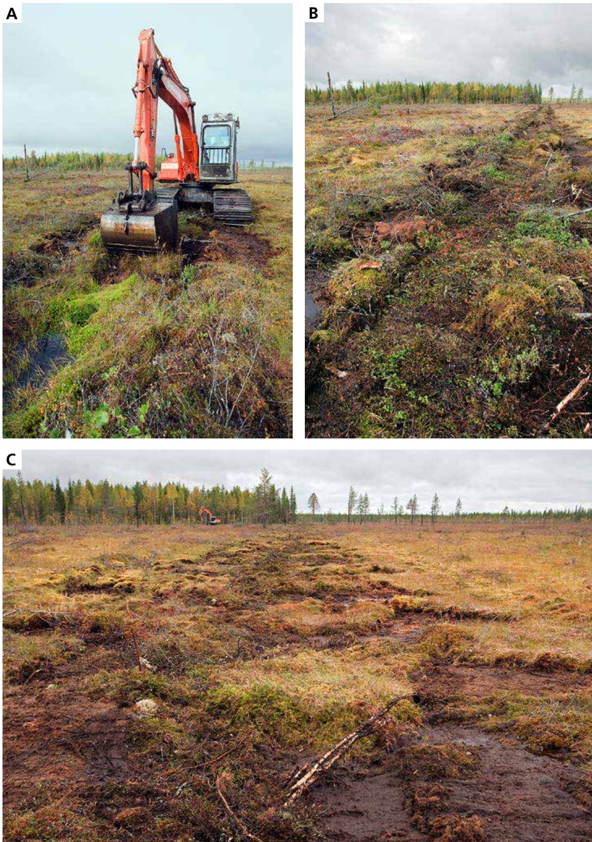
Kuva 25. Kaivinkone täyttämässä ojaa Porrassuolla Nurmeksessa syksyllä 2011 (A). Kaivinkoneen kuljettaja työskenteli täytettävällä ojalla kahteen suuntaan. Mennessään hän täytti ojan tiiviisti (B) ja palatessaan viimeisteli pintavallit ja vedenohjauksen (C). Alun perin avoimelta suolta hakattiin puusto edellisenä talvena. Kuvat: Philippe Fayt.
