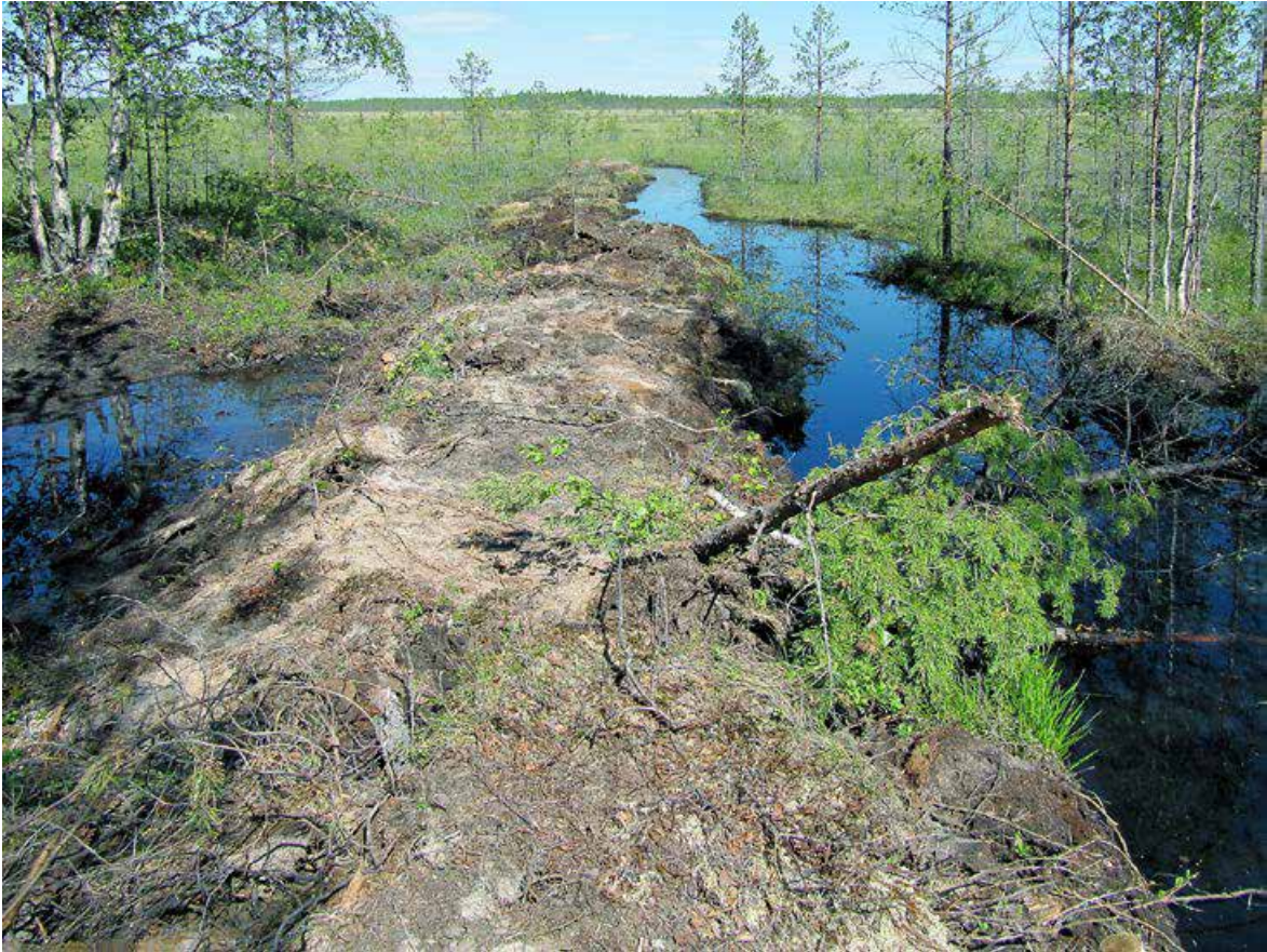
Kuva 28. Pohjoisnevaa ennallistettaessa keskeisiin vedenohjauskohtiin tehtiin noin 60 metriä pitkät pintavallit. Pintavallin paikka merkittiin kuitunauhalla maastoon ennen toimenpidettä, jotta kaivinkoneen kuljettaja tohti tehdä vallista riittävän pitkän. Oja, joka täytettiin ennallistamisen yhteydessä, on ollut suunnilleen kuvaajan kohdalla ja vesi on virrannut kuvan kohdassa oikealta vasemmalle. Pintavalli tehtiin kohtisuoraan ojan suuntaa vasten. Kohtaan, josta otettiin pintavalliin turvetta, muodostui uoma, jota pitkin vesi ohjautuu ojittamattomalle mutta kuivuneelle rimpinevalle. Pintavalli ja vedenohjaus toimivat hyvin ja neva on alkanut vettyä uudelleen. Alajärvi 2011. Kuva: Reijo Hokkanen.
