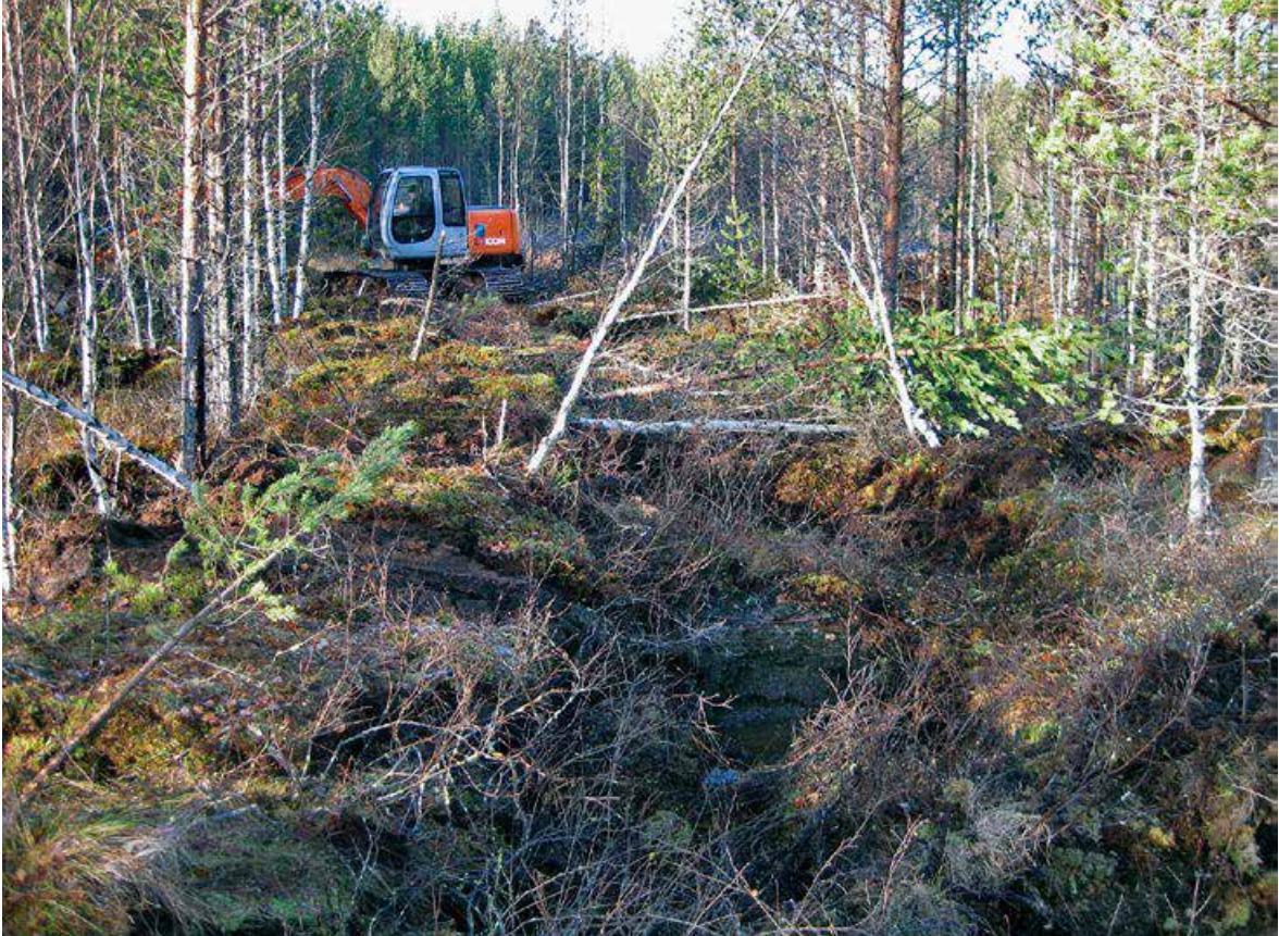
Kuva 120. Kaivinkone tekemässä pitkää patoa Vuosiaissalon pohjoispuolen ojikon laskuojaan lokakuussa 2009. Oja on kaivinkoneen kohdalla lähellä kankaan reunaa. Veden virtaus kuvassa oikealta vasemmalle, Vuosiaissalon metsäsaareke näkyy koneen takana. Kuva: Reijo Hokkanen.
