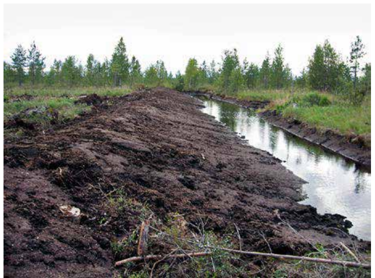
Kuva 104. Patovalli pari viikkoa työn tekemisen jälkeen. Kaivettu lammikko ei ole vielä täyttynyt vedellä. Kuva: Päivi Virnes, elokuu 2007.
