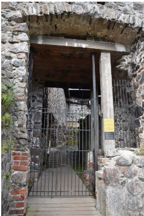
Vuosien 1959 ja 1961 välisenä aikana, eli jo ennen 1964 annettua Venetsian julistusta, Raaseporin linnan pääportti tuettiin betonirakenteella. Kuva: Sanna Ihatsu.
