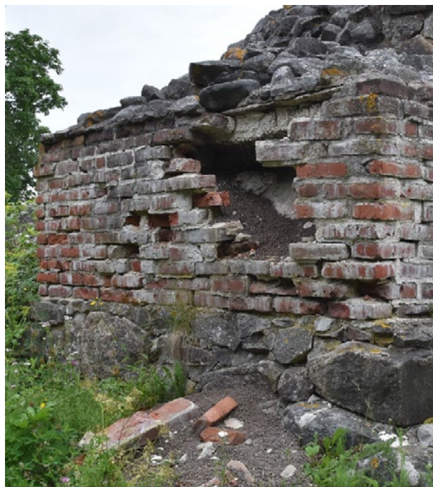
Verhorakenteiden taustalla käytettiin 1990-luvun lopulla leca-soraa. Rakenne ei ole kestänyt kovin hyvin. Kuva: Sanna Ihatsu.
