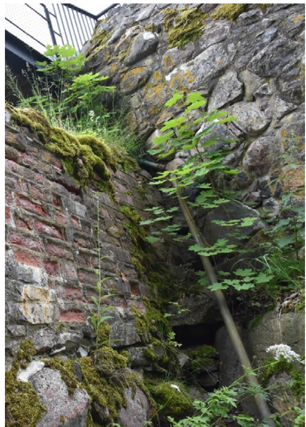
Pohjoispuolen portaan alapuolella kasvaa vesakkoa. Muuriin liittyvät myös katteen mahdolliset vesieristysongelmat. Kuva: Sanna Ihatsu.
