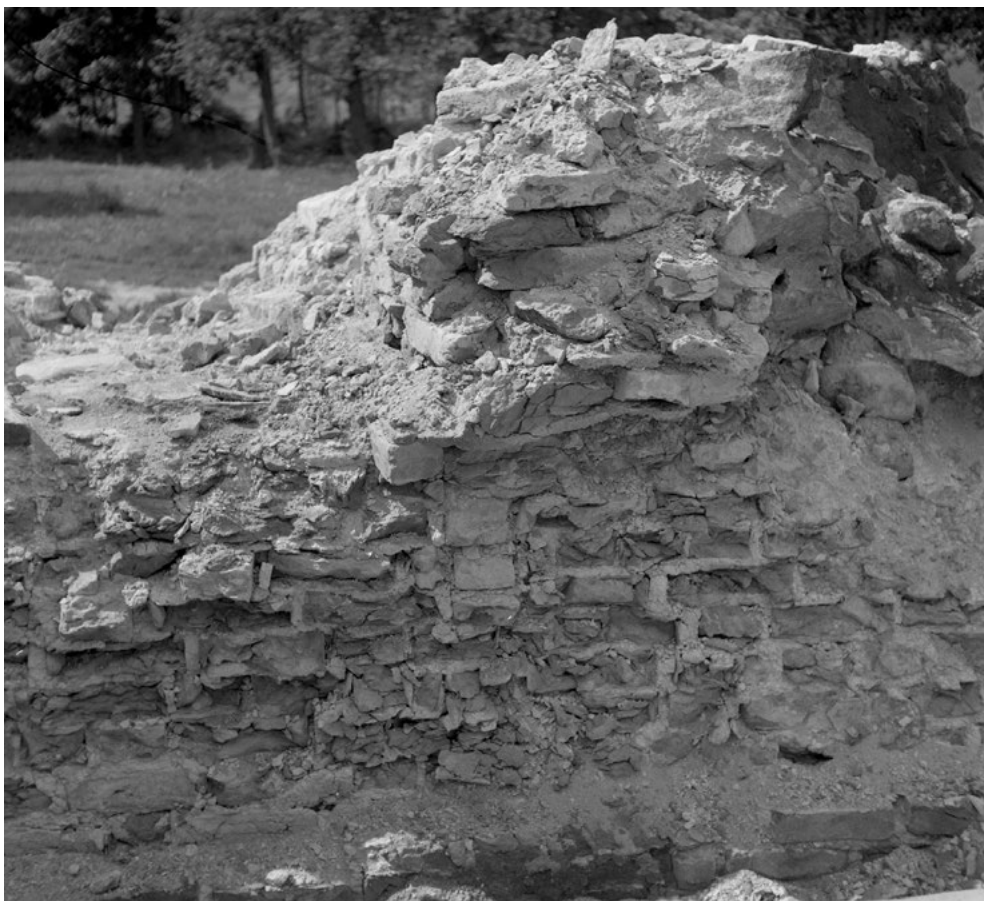
Päiväämätön ja nimeämätön kuva arviolta 1960-luvun alusta esilinnan kehämuurista. Sortumamassojen alta esiin kaivettu tiili rapautuu hyvin nopeasti jäätyään sään armoille. Kuusiston linnan raunio, Museovirasto, Rakennushistorian kuvakokoelma, RHO126346:10, finna.fi.
