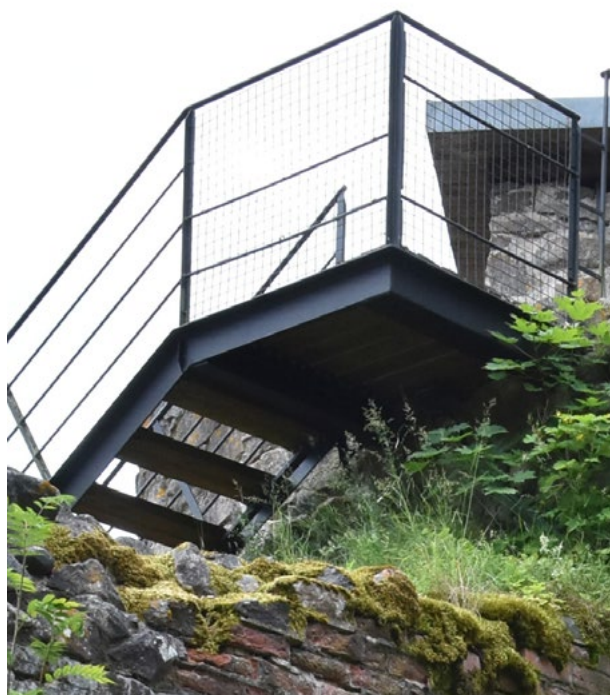
Kaiteista puuttuvat pienet ja harvat vaakakaiteet on parannettu tiheämmän verkon avulla vastaamaan nykymääräyksiä. Kuva: Sanna Ihatsu.
