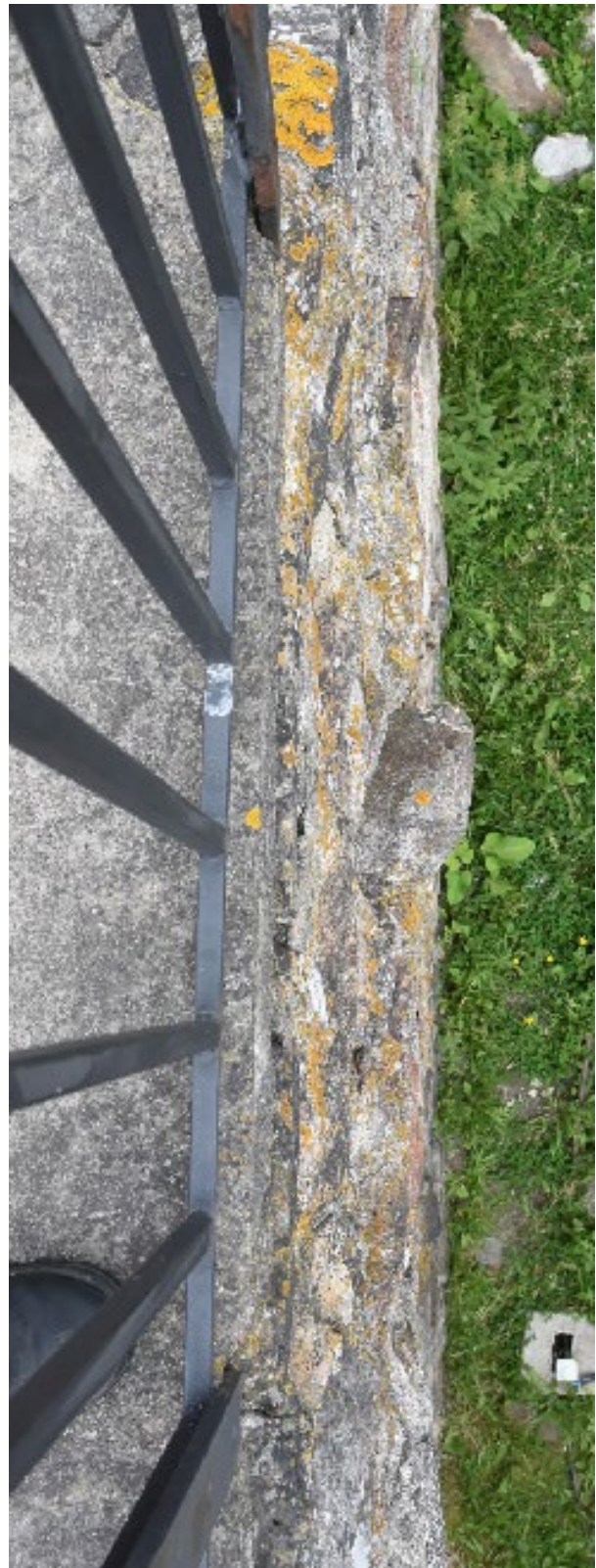
Yksittäinen, putoamaisillaan oleva irtokivi sisääntulon vieressä, huoneessa R. Ilmoitettiin turvallisuusriskinä heti käynnin jälkeen tilaajalle, joka lupasi poistaa/kiinnittää kiven pikimmiten. Seinässä on laajempia vaurioita, jotka on kirjattu vauriokartoituksen kohdassa M9. Kuva: Sanna Ihatsu.
