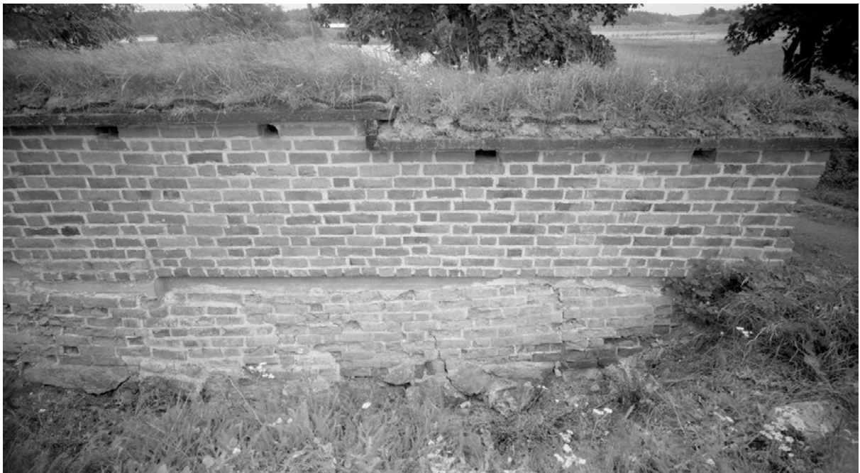
Kehämuurin tiiliverhouksen rakentaminen suoraan vanhan tiilimuurauksen päältä joudutti arkkitehti Esko Vormalan mukaan vanhojen tiilien rapautumista. Kuusiston linnan rauniot. Valokuva: Museovirasto, rakennushistorian kuvakokoelma. RHO126346:109, finna.fi.
