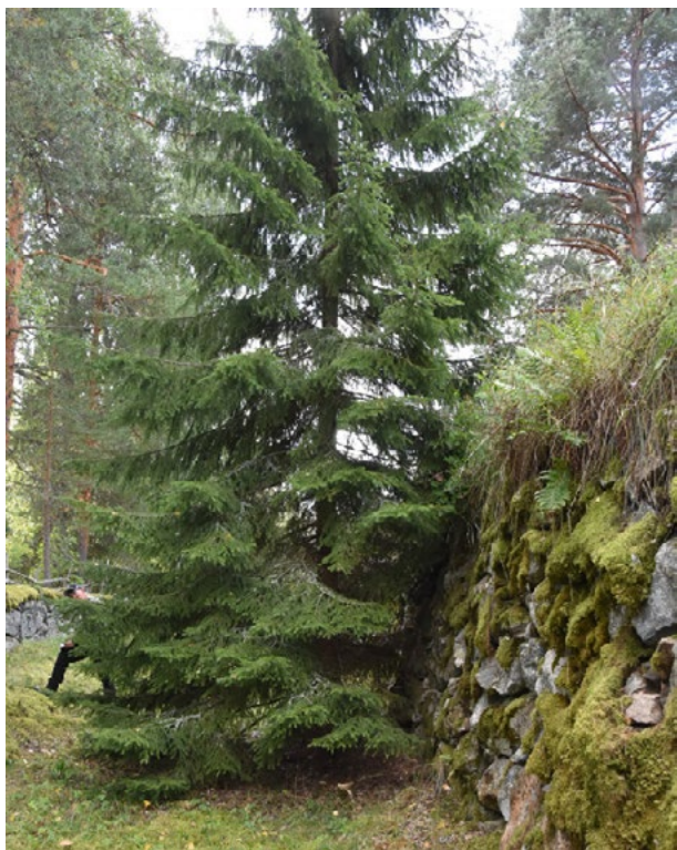
Vallin vieressä kasvavan kuusen juuret tunkeutuvat vähitellen muurin perustuksiin. Kuva: Sanna Ihatsu.
