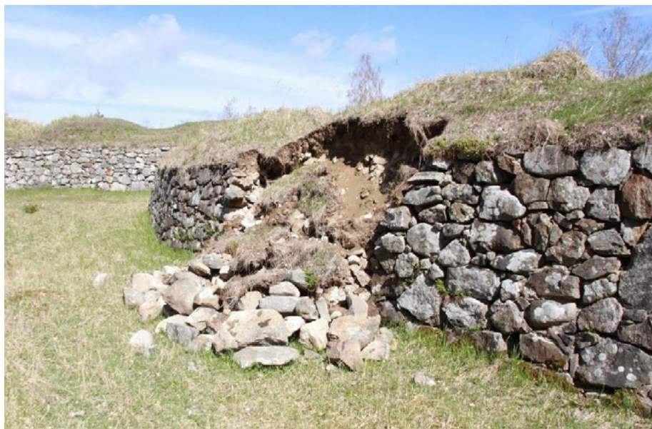
Ravelliini C:n oikean sivun romahduskohta ennen korjausta. Kuva: Hilja Palviainen, MH.
